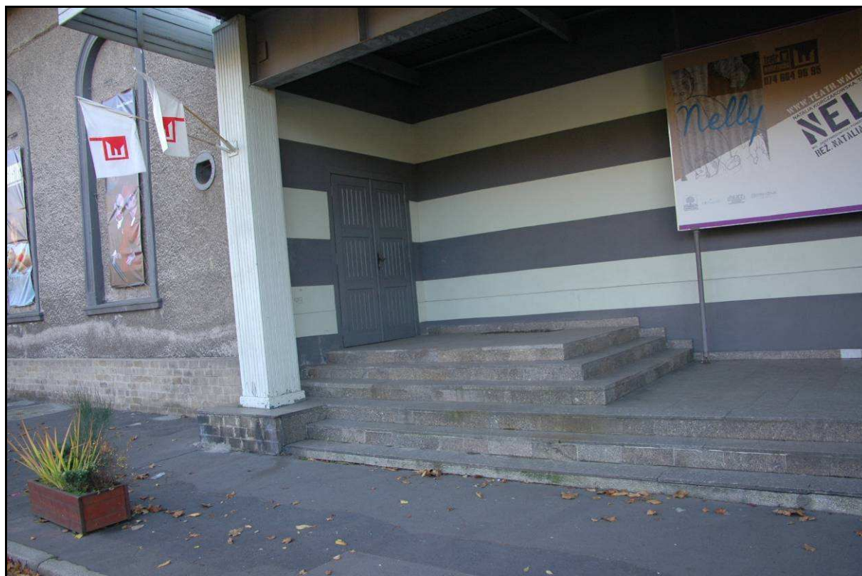
Fotografie 13. i 14. Teatr Dramatyczny. Osoby poruszające się na wózku inwalidzkim mają do sforsowania potrójną przeszkodę: wysoki krawężnik oraz główne i boczne schody prowadzące do wejścia. Trudno porusza się również wewnątrz budynku.
