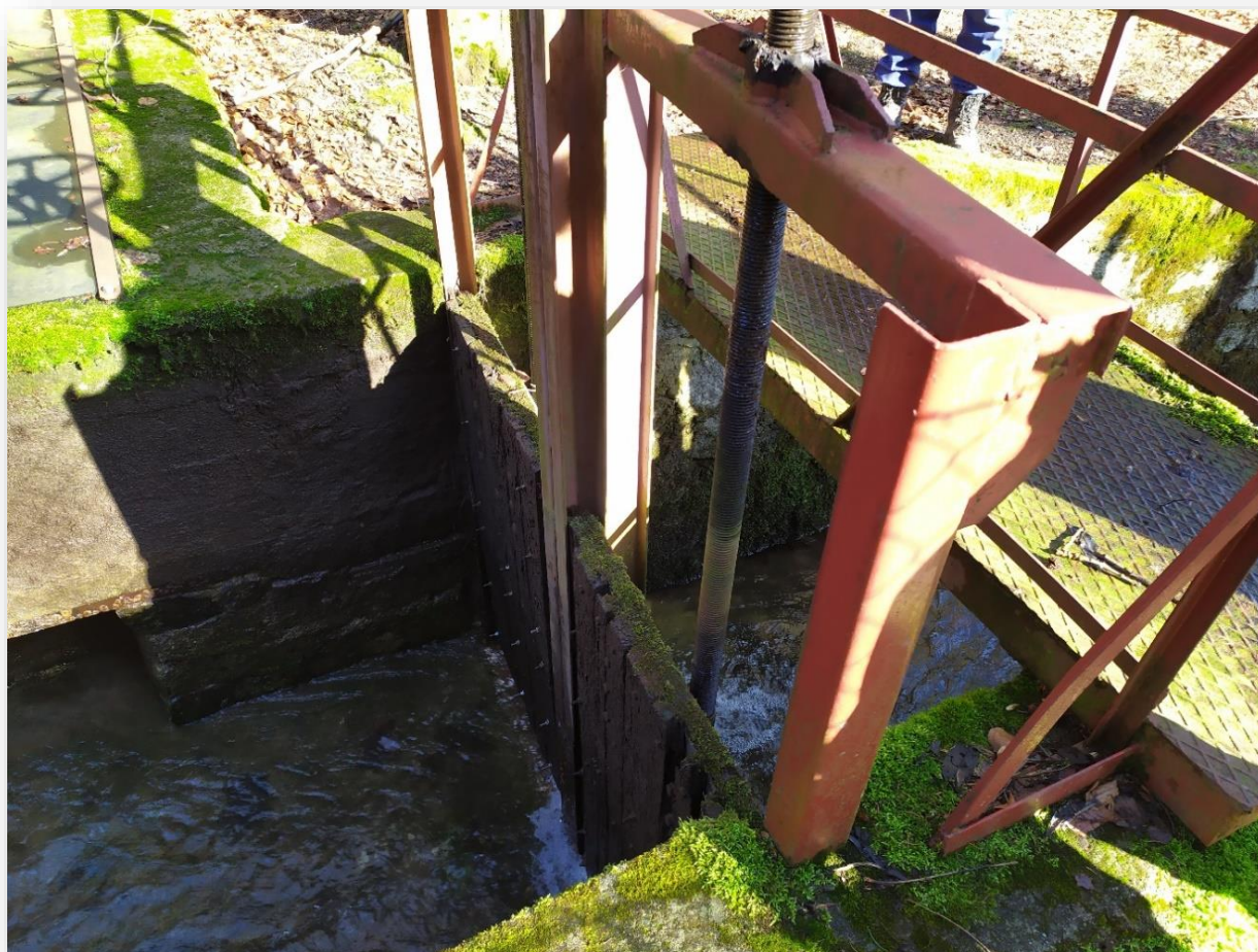
Zdjęcie 10. Piętrzenie wód powierzchniowych na ujęciu w Łomnicy; źródło: materiały WPWiK Sp.z o. o.
